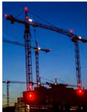
Lampes de signalisation sur des grues
